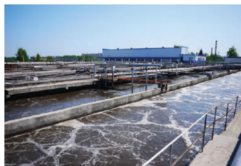
Очистные сооружения в г. Щелково
